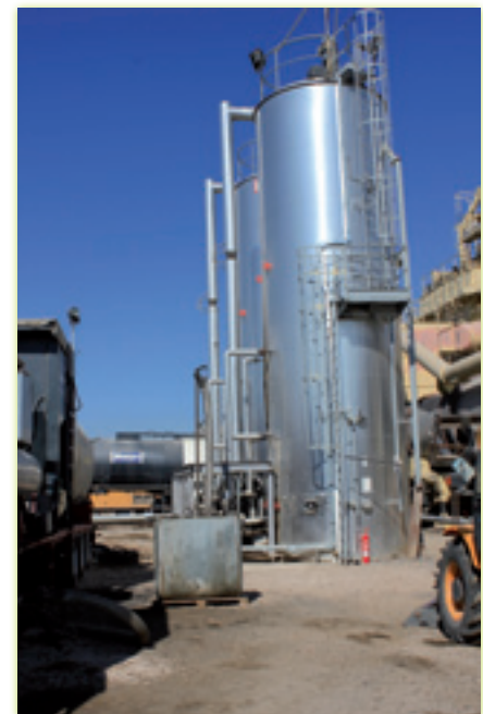
Figure 20. Réservoirs auxiliaires de stockage
