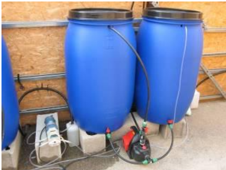
Figure 5 : Vue du système de recirculation des eaux de la nappe
